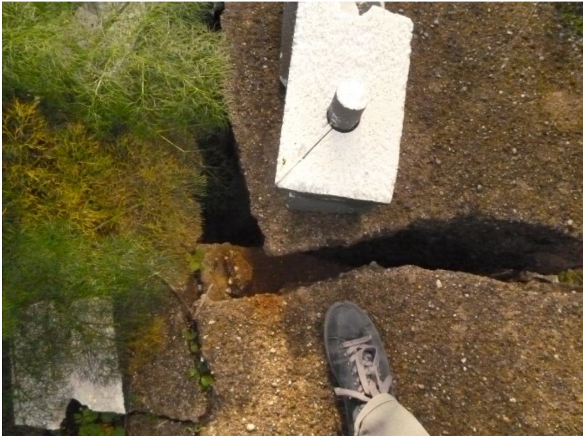
Figura 26 - dissesti infrastruttura viaria
