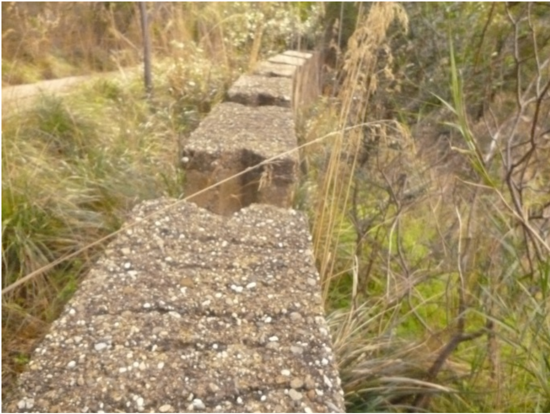
Figura 28 - dissesti infrastruttura viaria
