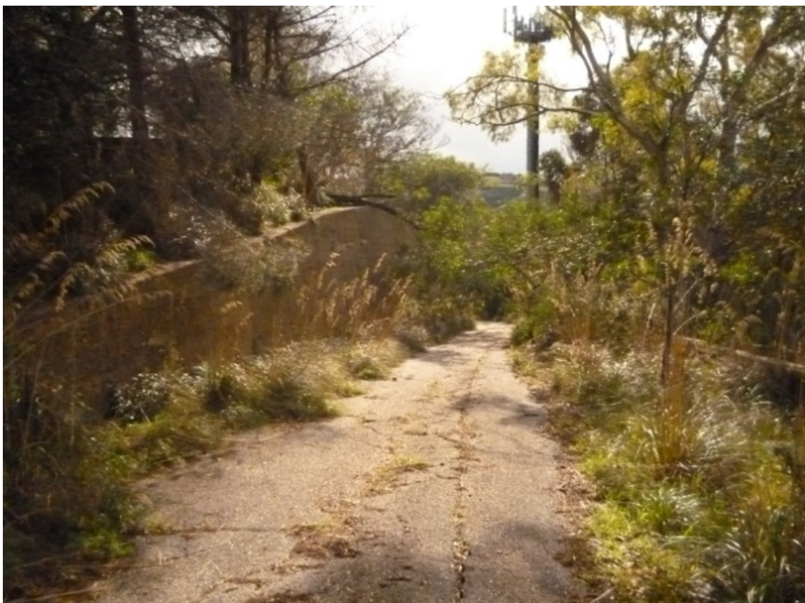
Figura 27 - dissesti infrastruttura viaria
