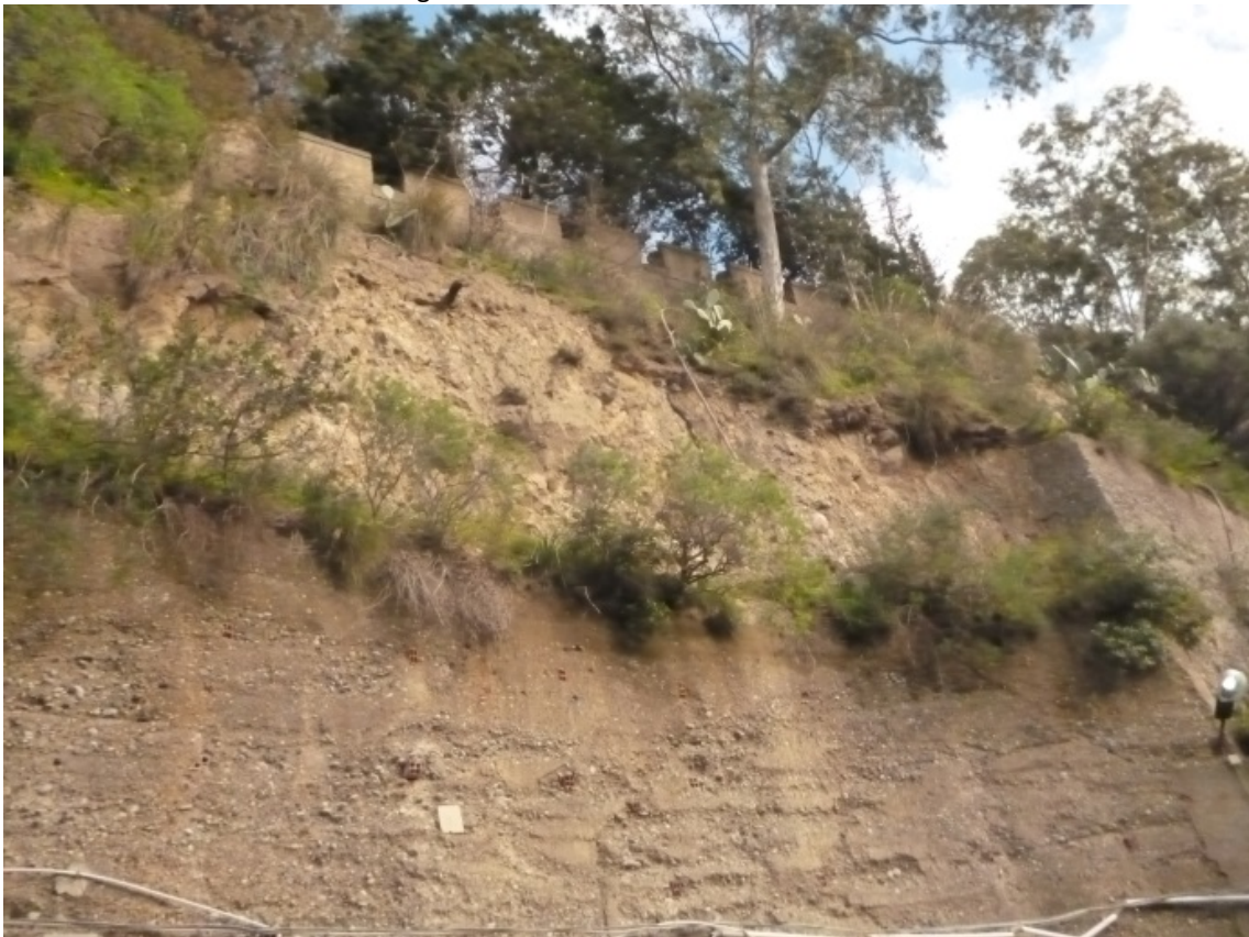
Figura 29 - Instabilità pendio e insufficienza struttura di contenimento
