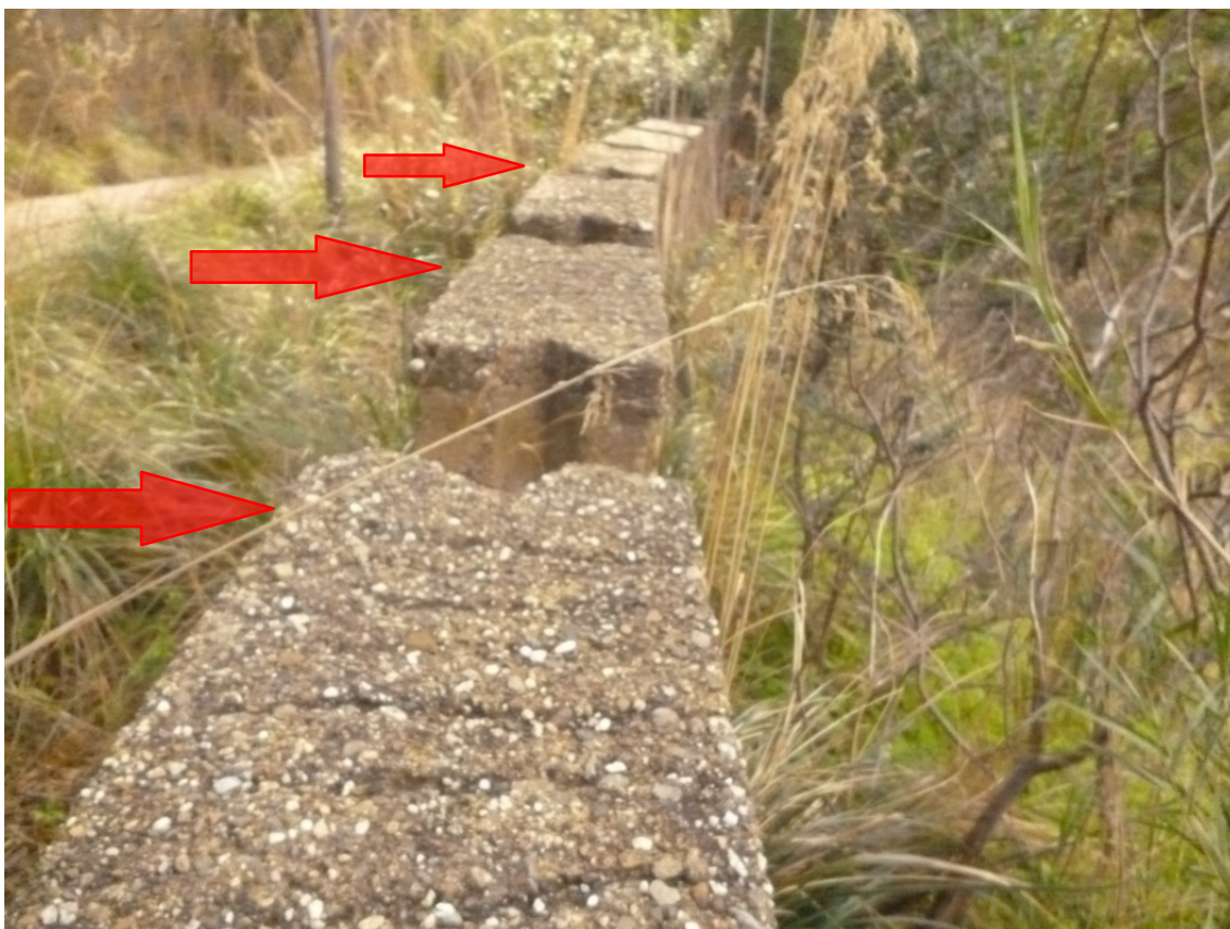
Figura 32 - dissesto infrastruttura iviaria
